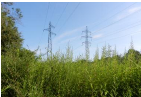
2 lignes 63 Kv concernées - linéaire cumulé de 1700 m
